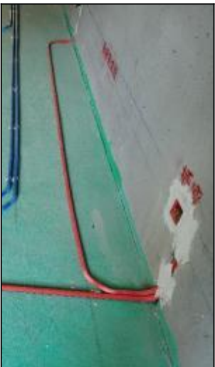
线管内电线不允许有接头
