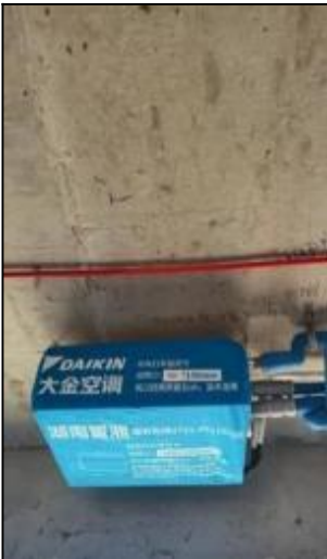
中央空调、风管机内机：2.5平方
