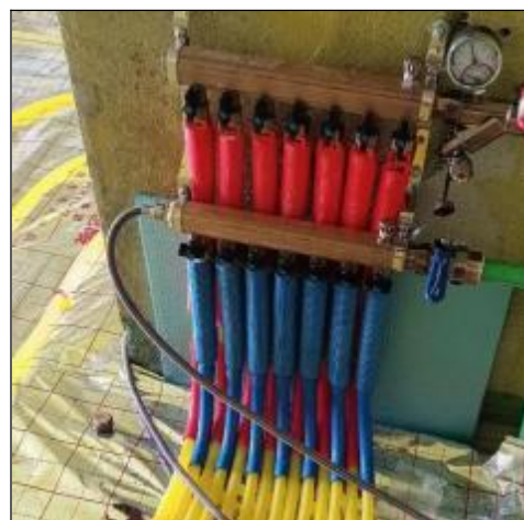
地暖分水器安装位置
